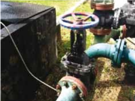
Liqueo en una llave Manifold, un problema que es frecuente.
