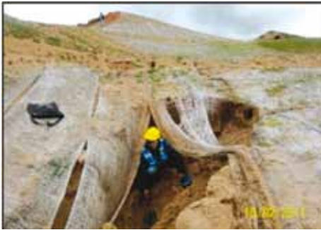
Alerta Temprana de un grave deslizamiento y exposición del ducto en la comunidad campesina Mayobamba, Ayacucho.
